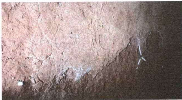
Foto 5: Piso quebrado y deteriorado del salón de clases.
